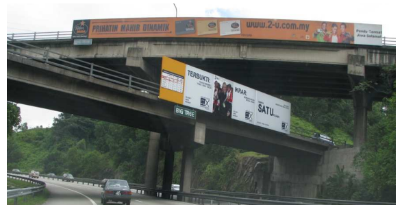
Papan iklan jejambat yang dipasang secara menyerong memberi gangguan serta membahayakan pengguna jalan raya dan tidak dibenarkan.
